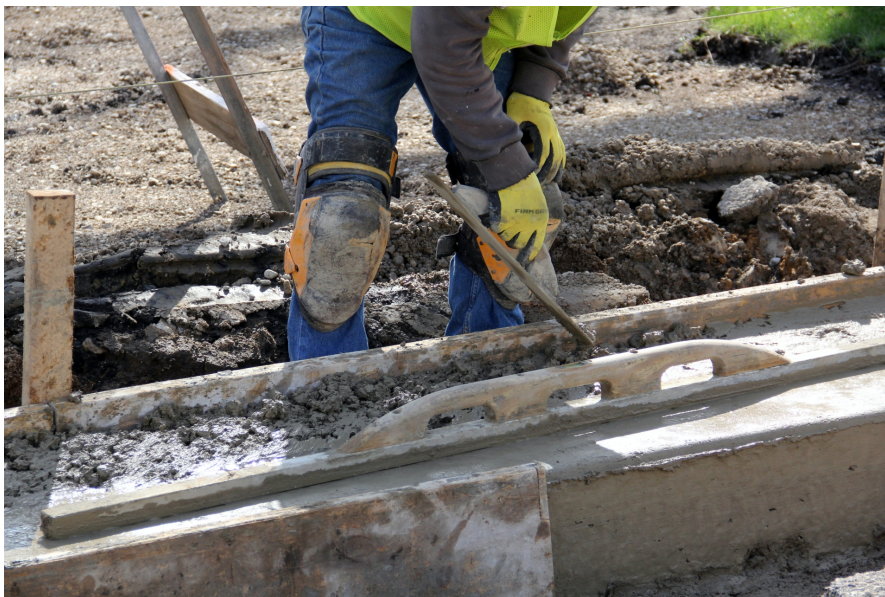
Situazione fuori controllo, secondo i vertici di Ance: rincari sino al 400% dei materiali, occorre una revisione urgente del prezzario regionale
